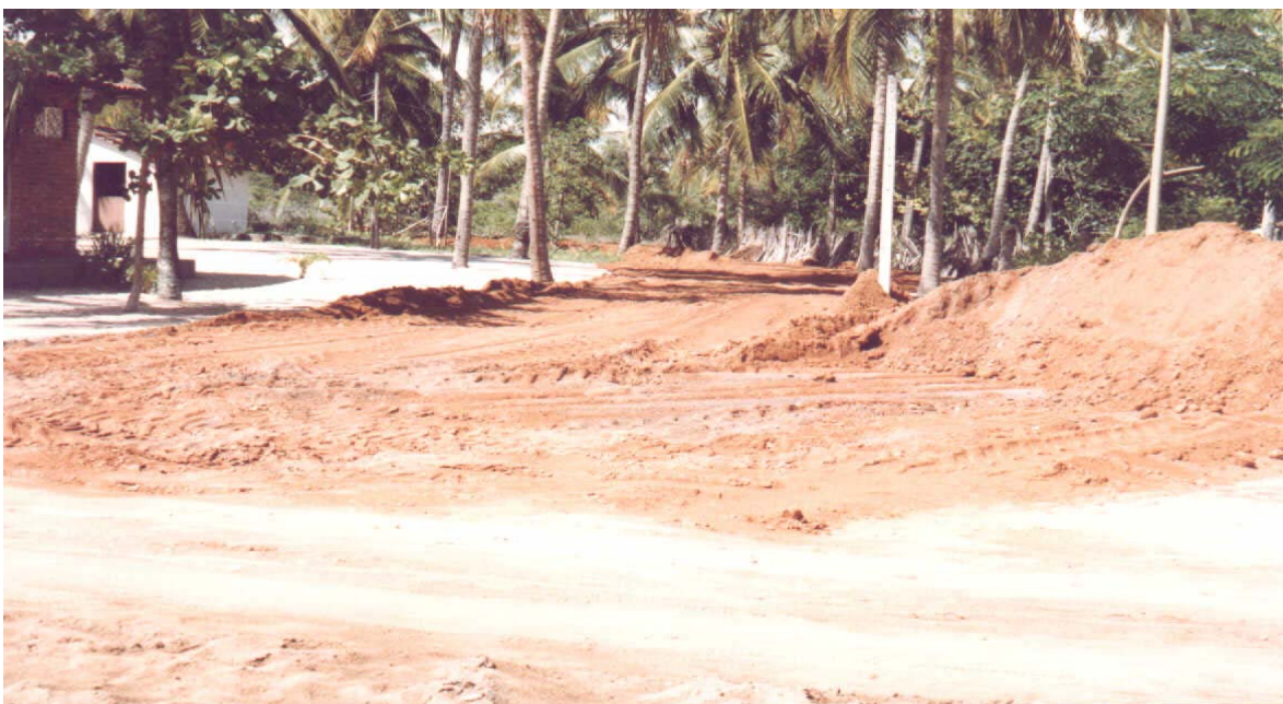
Foto XVI: Aterro de parte da Mata para aumentar a área de deposição de material apreendido pelo IBAMA. Foto: Elivan Arantes.
